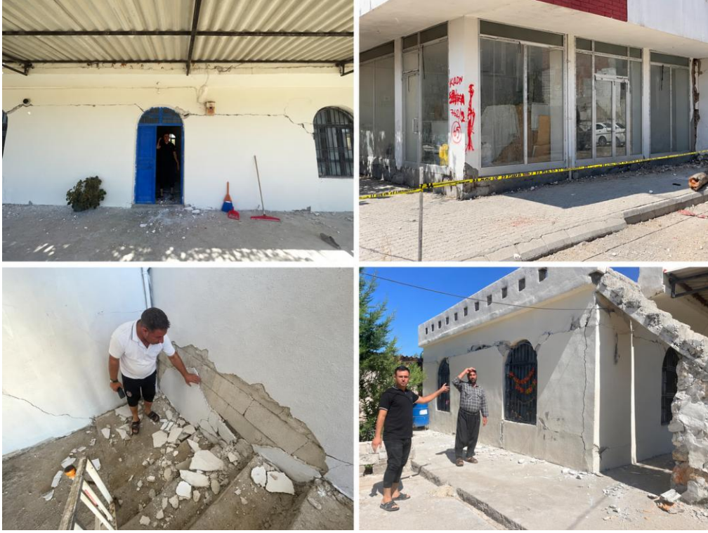
Şekil 3. 24 Eylül 2026 Şanlıurfa–Karaköprü depremi sonrasında yapılarda gözlenen duvar çatlakları ve kısmi yıkımlar. Fotoğraf kaynakları: Evrensel ve Haber7 (2026)
